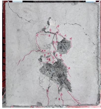
(d) P-C-12-40-10 in failure stage
